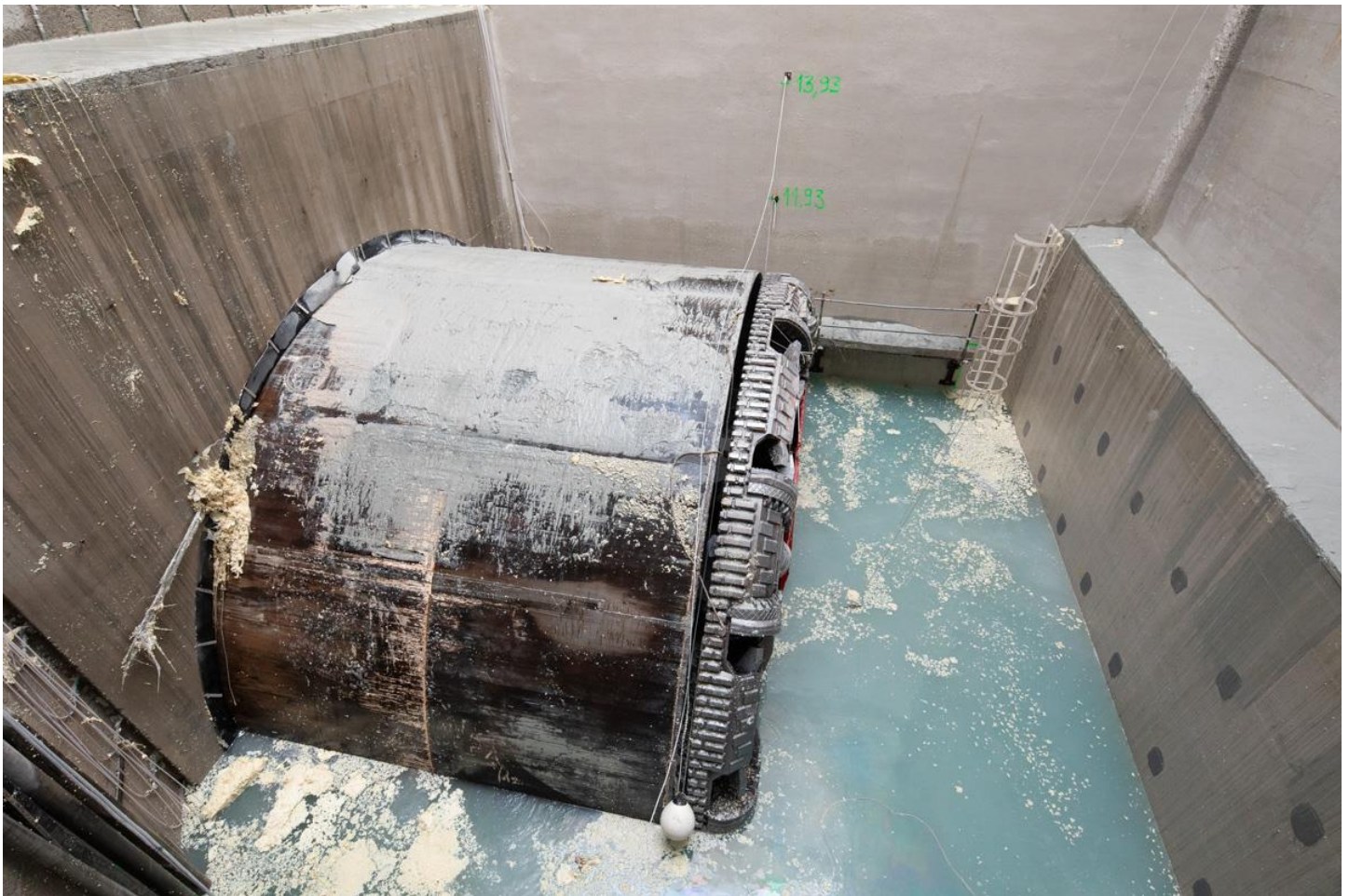
Le tunnelier Valérie à l'ouvrage Cachin, dimanche 18 avril 2021. © Société du Grand Paris / Claire-Lise Havet
